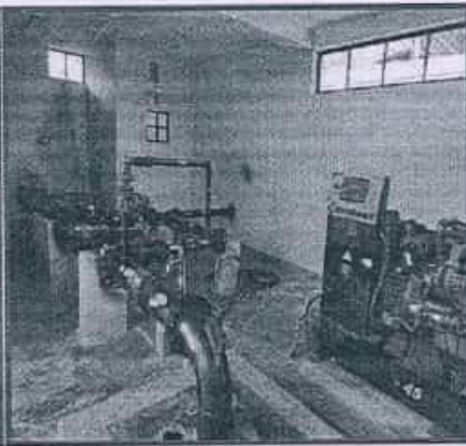
Imagen N° 07 Sistema de captación subterránea
