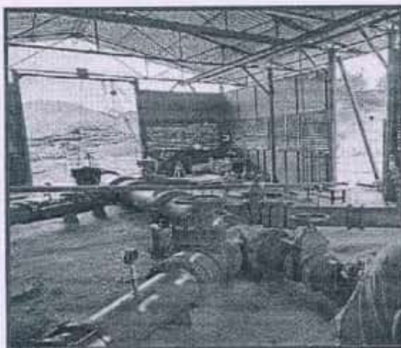
Imagen N° 06 Sistema de Captación Superficial
