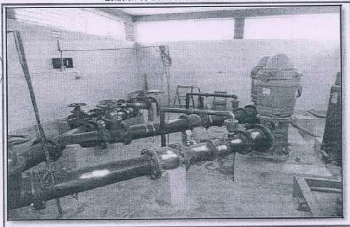
Imagen N° 28 Estación de Bombeo Las Colinas
