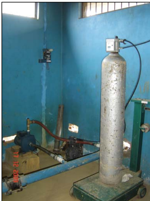
Foto N°3: Sistema de Desinfección Cloro Gas
