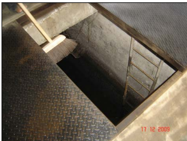
Foto N°13: Cámara de Bombeo
