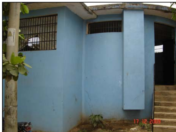
Cuadro N°13: Cámaras de Bombeo de Desagües
