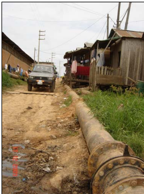
Foto N°5: Línea de Impulsión – Captación Robalino a PTAP
