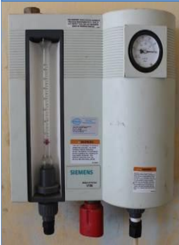
EQUIPO DE CLORACIÓN
