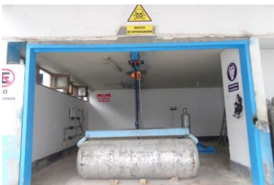
Sistema de Izaje de Cilindro de Cloro
