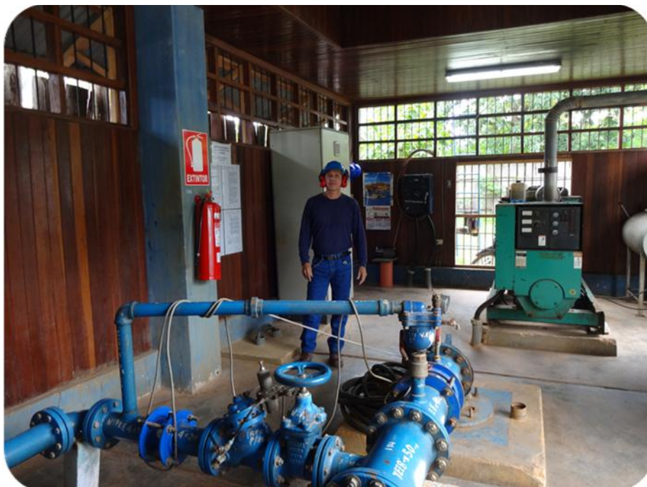
Operador de Pozo de Agua Subterránea Palmeras II, con todos sus implementos de seguridad.
