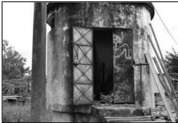
Imagen N° 32: Cámara de Bombeo de Desagüe D-15
