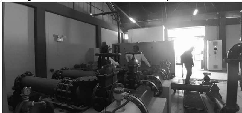
Imagen N° 13: Infraestructura hidráulica de pozos del sector 12
