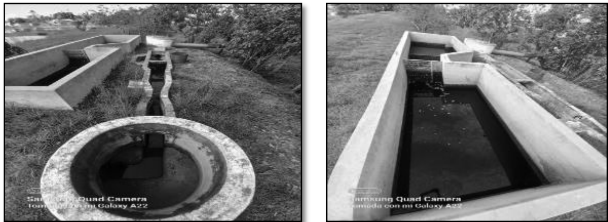
Imagen N° 41: Cámara de Llegada a la PTAR de Lagunas
