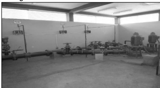
Imagen N° 14: Estación de Bombeo Padre Salas
