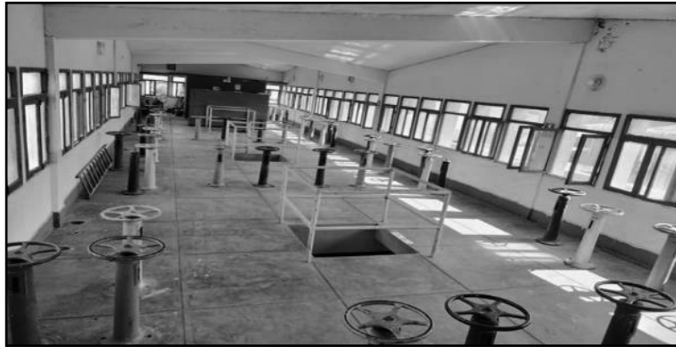
Imagen N° 23: Sala de operación de válvulas
