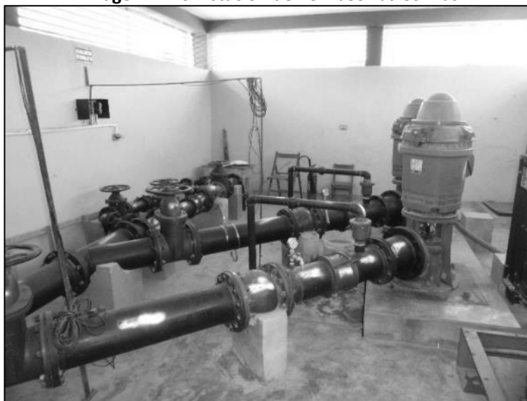
Imagen N° 16: Estación de Bombeo Las Colinas
