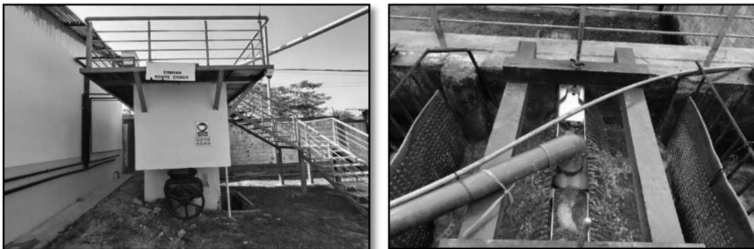
Imagen N° 21: Mezcla rápida de la PTAP
