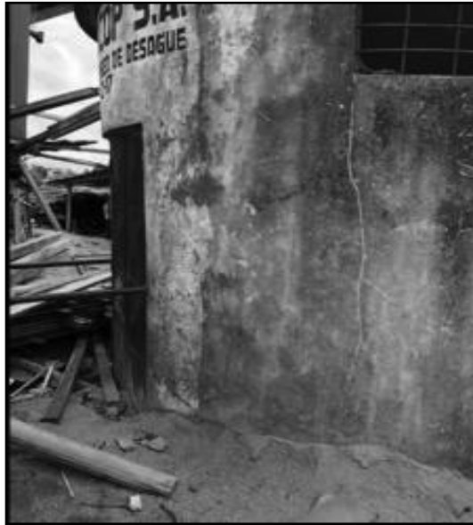
Imagen N° 31: Cámara de Bombeo de Desagüe D-17
